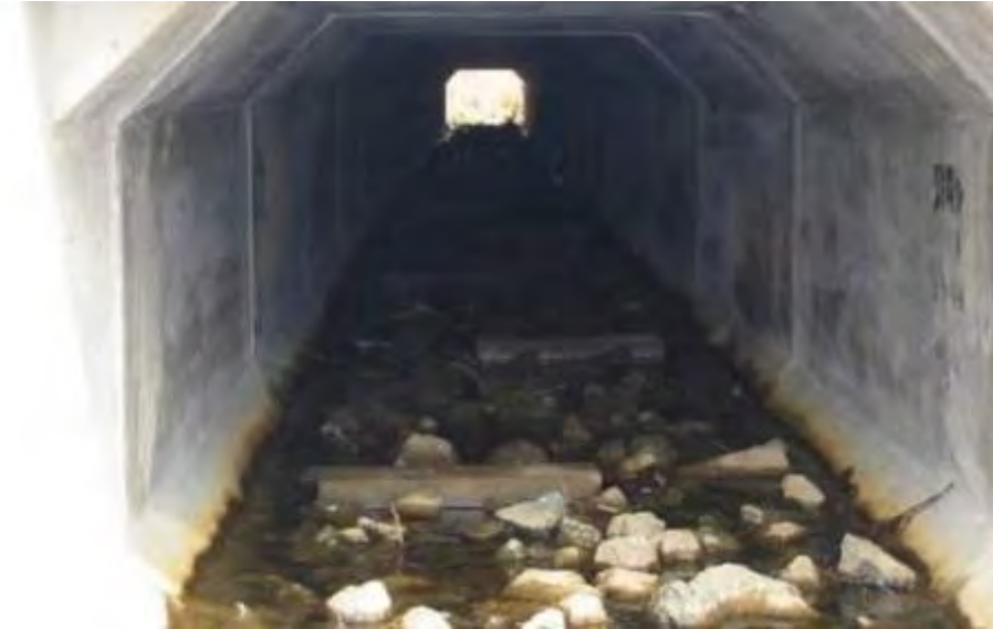
Abbildung 20: Sohlgestaltung im Durchlass mit Geröll und Kies. Quelle: H.-Diel (GFG GmbH)
